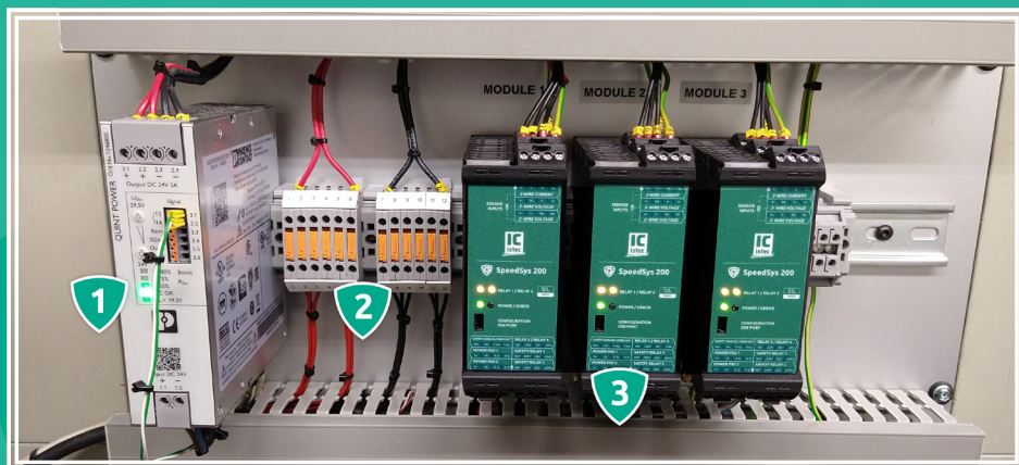
Figura 3 - La nueva instalación ODS compuesta por una fuente de alimentación SELV con aislamiento galvánico (1), una distribución doble de 24 V para redundancia opcional (2) y tres unidades SpeedSys 200 cableadas en una estructura de votación 2oo3 (3).
